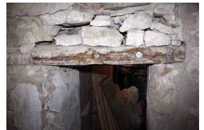
L'accesso al pollaio nel prospetto occidentale secentesco della casa colonica, che attualmente è venuto a trovarsi al di sotto della scala tardo-ottocentesca
